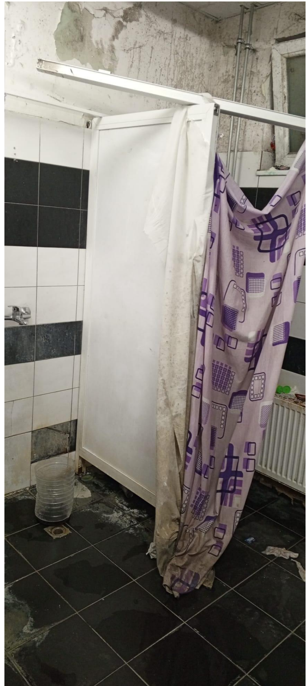
Abbildung 5: Wenn Sanitäre Anlagen kaputt gehen, werden diese im Camp Harmanli nicht repariert.
